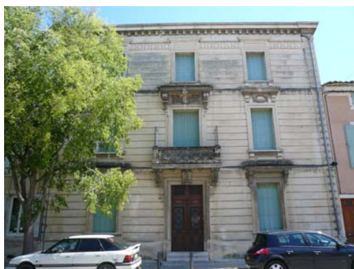
Mur en pierre de taille
