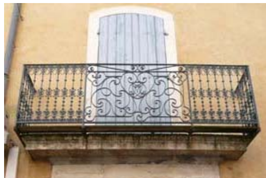
La finesse et la « transparence » des garde-corps contribuent à la qualité de cette façade.
