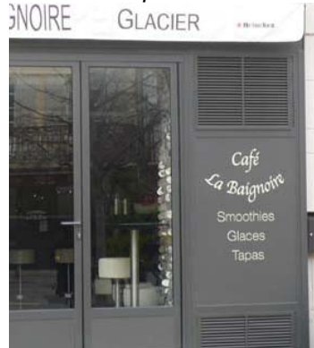
Les climatiseurs peuvent être placés comme ici, derrière des panneaux ajourés.
