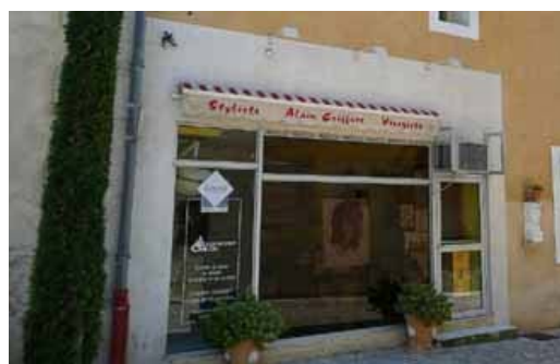
Climatiseur : la pose en applique et en saillie est interdite
