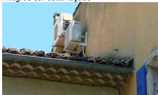
Les climatiseurs en applique, visibles de la rue sont à éviter.
