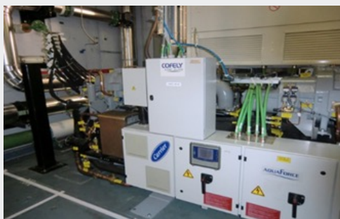
Nouveau groupe froid (+ 50% de capacité frigorifique)
