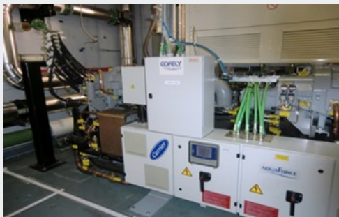
Nouveau groupe froid (+ 50% de capacité frigorifique)
