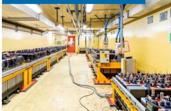
Locaux contenant les batteries
